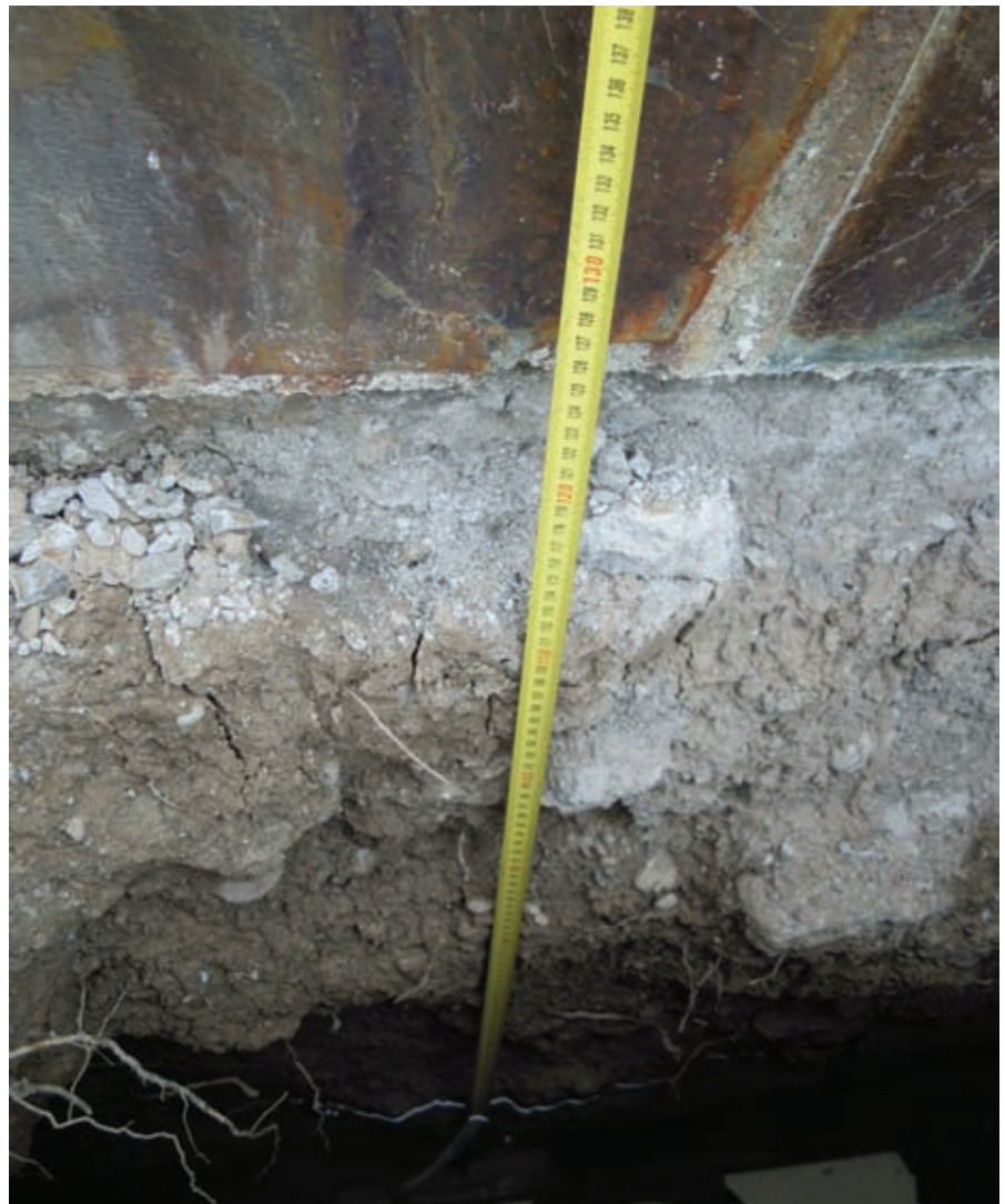
Figura 6. Ausencia de cimentación.
