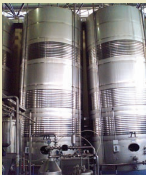
Figura 16. Inclinación de silos, antes de la inyección.
