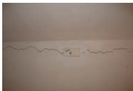
Figura 1. Colocación de testigo de yeso sobre grieta horizontal en techo.
