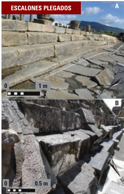
Figura 10. Escalones plegados en: A) escaleras de acceso al foro de la ciudad romana de Baelo Claudia (Cádiz, España) y B) escalones deformados y "extruídos" en la escalinata de la pirámide de Quetzalcoatl en la ciudadela de Teotihuacan (México).
