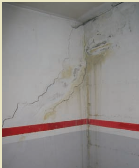
Figura 13. Fisuras inclinadas en esquina interior.
