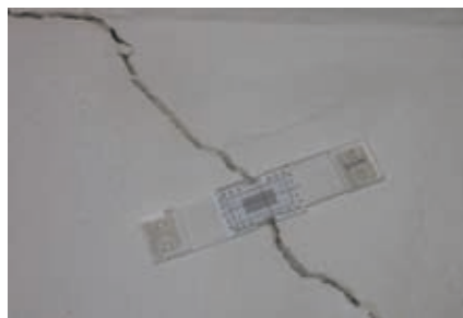
Figura 2. Colocación de fisurímetro en fisura inclinada en muro de carga interior.
